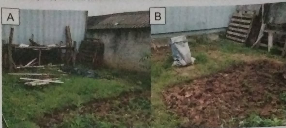
Figura 4: figura (a) local antes da retirada de entulhos e preparo do solo, figura (b) após retirada de entulhos.
